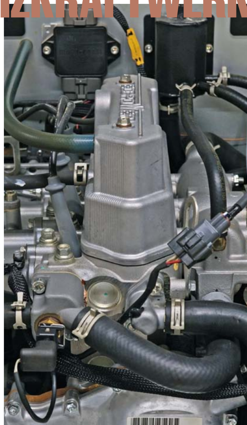
Innenansicht Blockheizkraftwerk der Wohnanlage CampusQuartier in Osnabrück.
